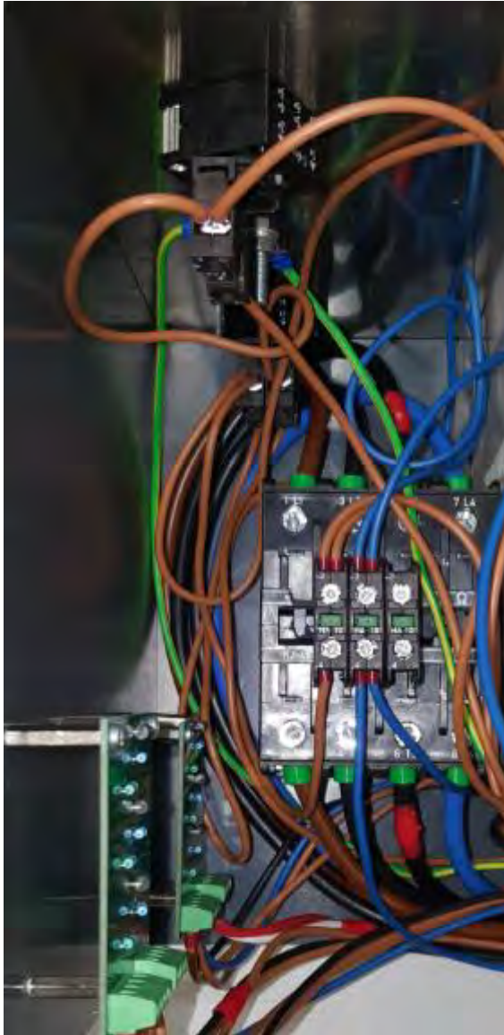
Abbildung 17 : Innenleben Leistungsschütz, Taster und Spannungsteiler
